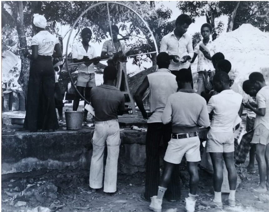
Figure 10 : Photographie de la construction d'un puits au CEPI de Cufar, non datée
